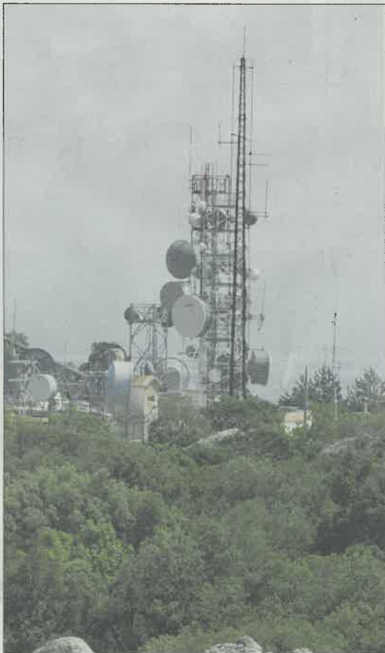
Les dispositifs de radiodiffusion situés au sommet de la montagne de La Loube, sur les hauteurs de La Roquebrussanne, « arrosent » toute la plaine de Brignoles et de Saint-Maximin. (Photo doc Sophie Donsey)
